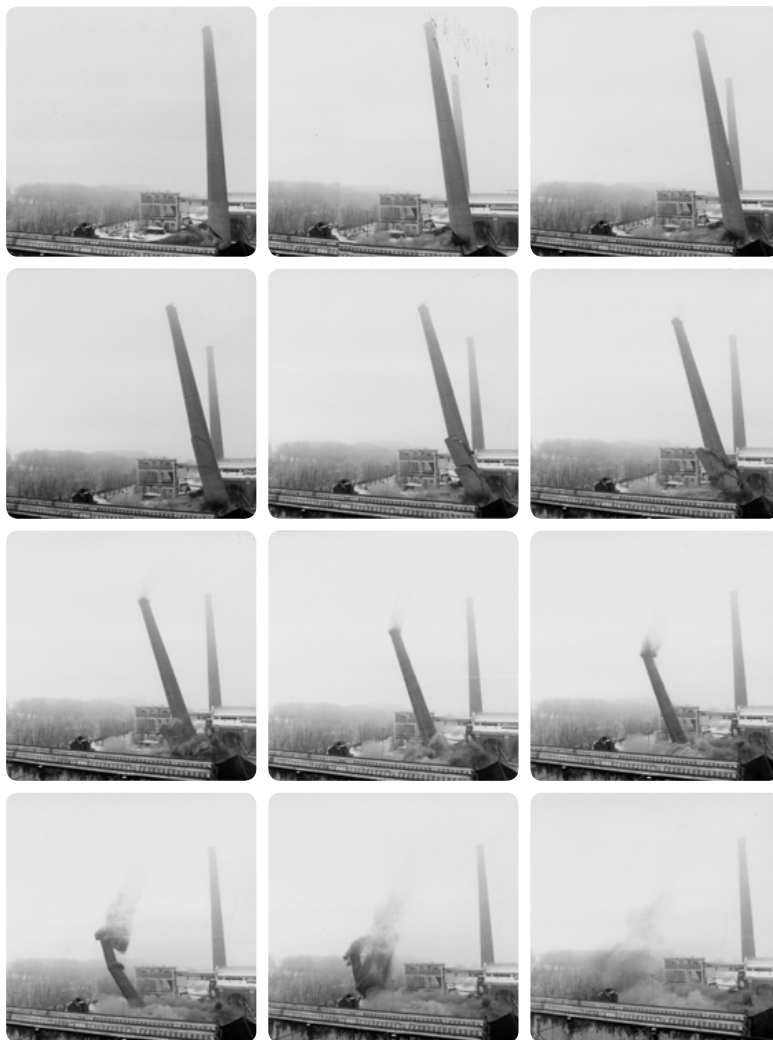
▲ Chute des cheminées de la B.T.T
